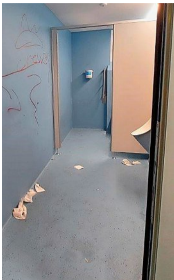
Schmierereien und beschädigte Toiletten.
