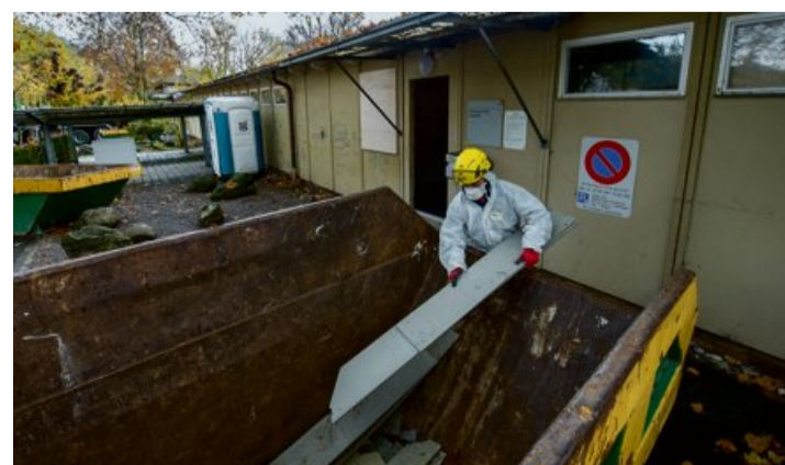
Der Abbruch hat begonnen: Seit gestern nehmen Arbeiter die Seefeld-Baracke, die auch belastete Teile enthält, auseinander.
